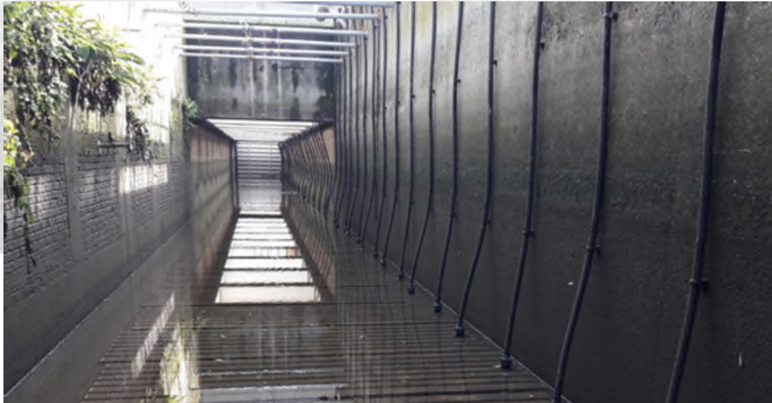
Effluentgoot Eindhoven (Lucht via platen)
